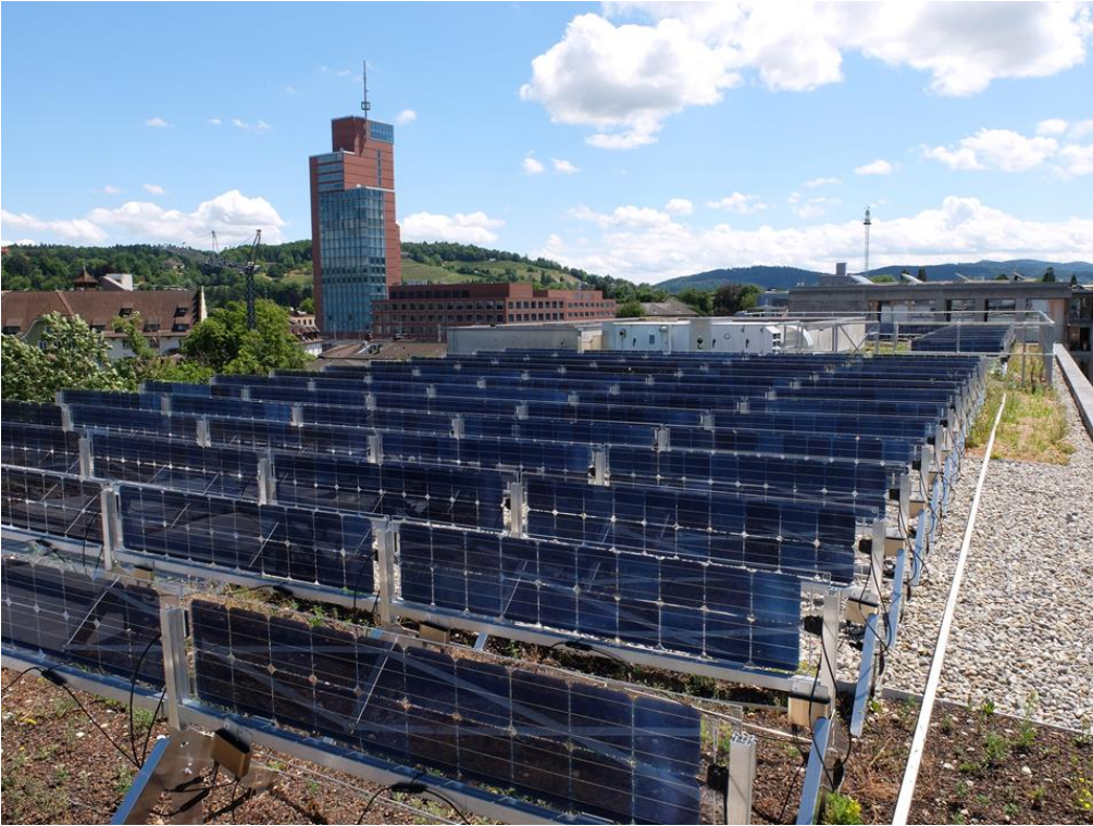
Energiegründach Eichgut in Winterthur in der Schweiz
