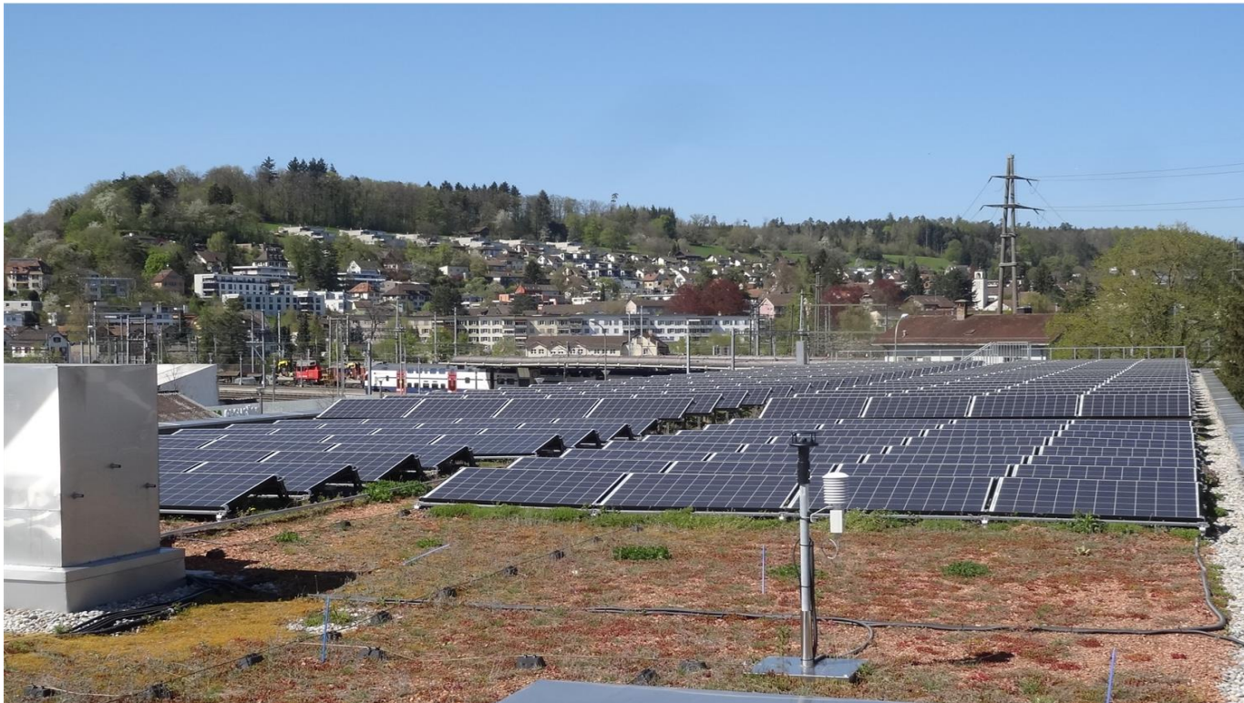
Energiegründach Werkhof Scheidegg in Winterthur in der Schweiz
